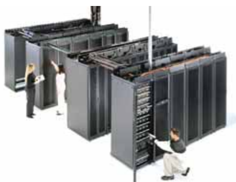
InfraStruXure per Sale CED di Grandi Dimensioni (100+rack)
